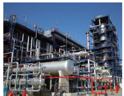
分解油水添脱硫装置
