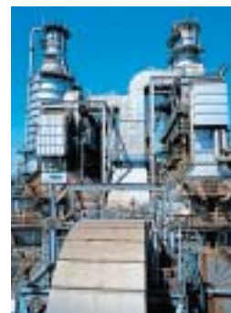
排煙中のNOxを除去する排煙脱硝装置
