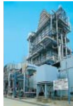
千葉製油所の コージェネレーション設備
