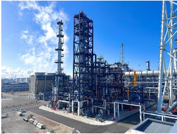
建設が完了した SAF 製造装置 (コスモ石油堺製油所構内)
